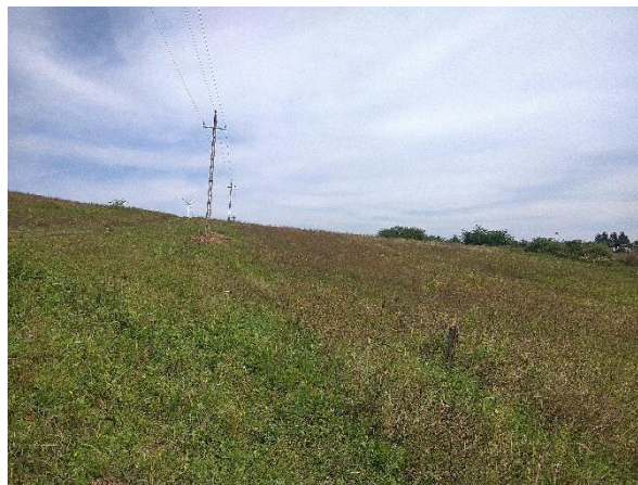
62. ábra 20 kV-os légvezetékes hálózat
